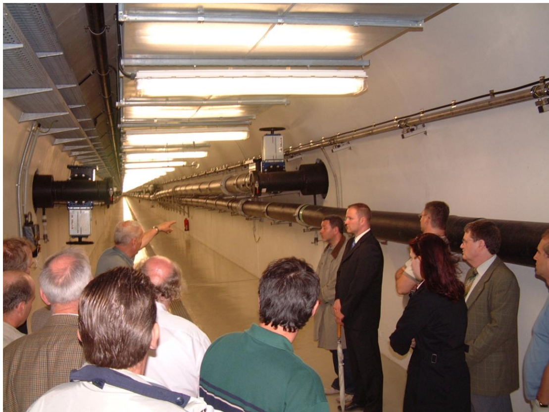
Tunnel zur Erfassung und zum Abpumpen des Deponiesickerwassers auf der Deponie Schöneicher Plan
